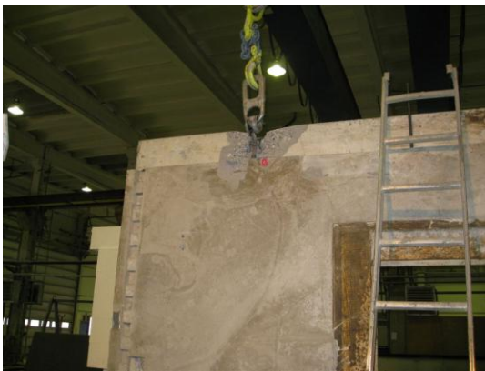
Figur 2.1.1– Lyftanordning med bortfallen betong
